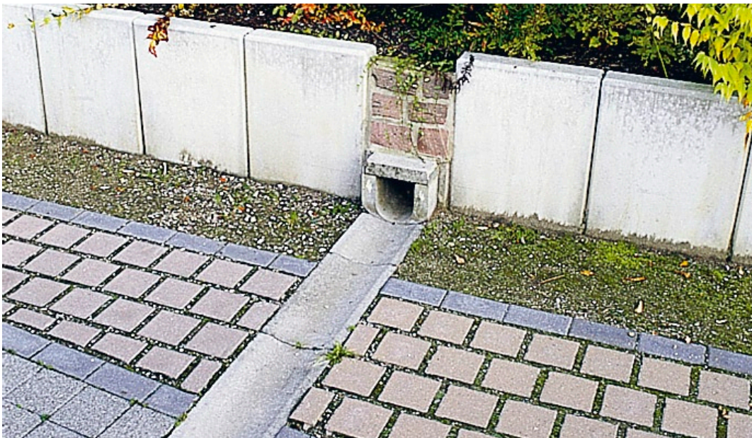
Abb.: Überlauf, Regenwasserspeicher in Mulde.
