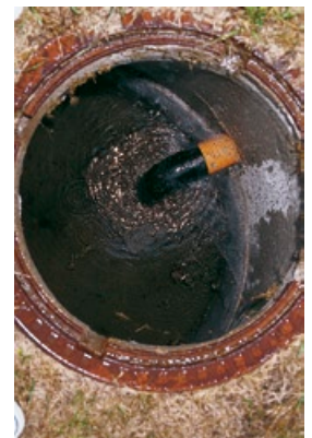
Abb.: Schacht aus Beton
